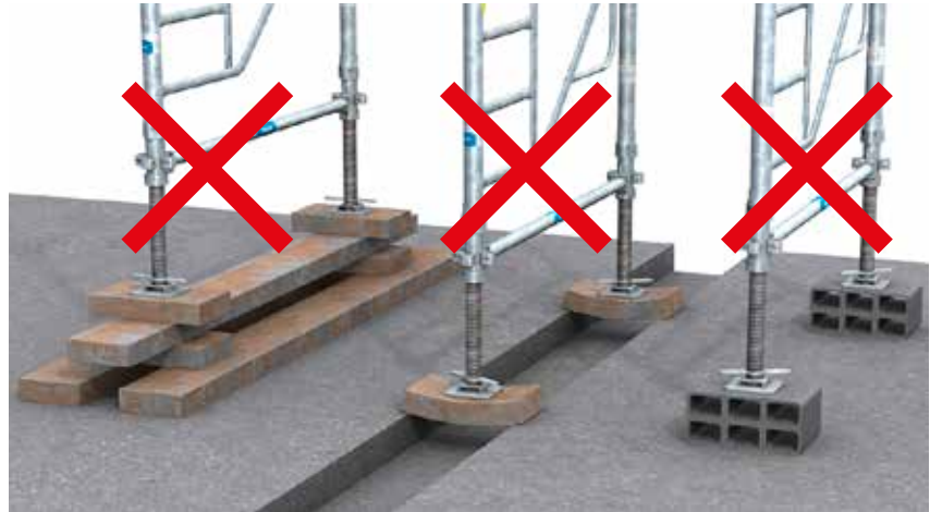
Empilage excessif de cales
